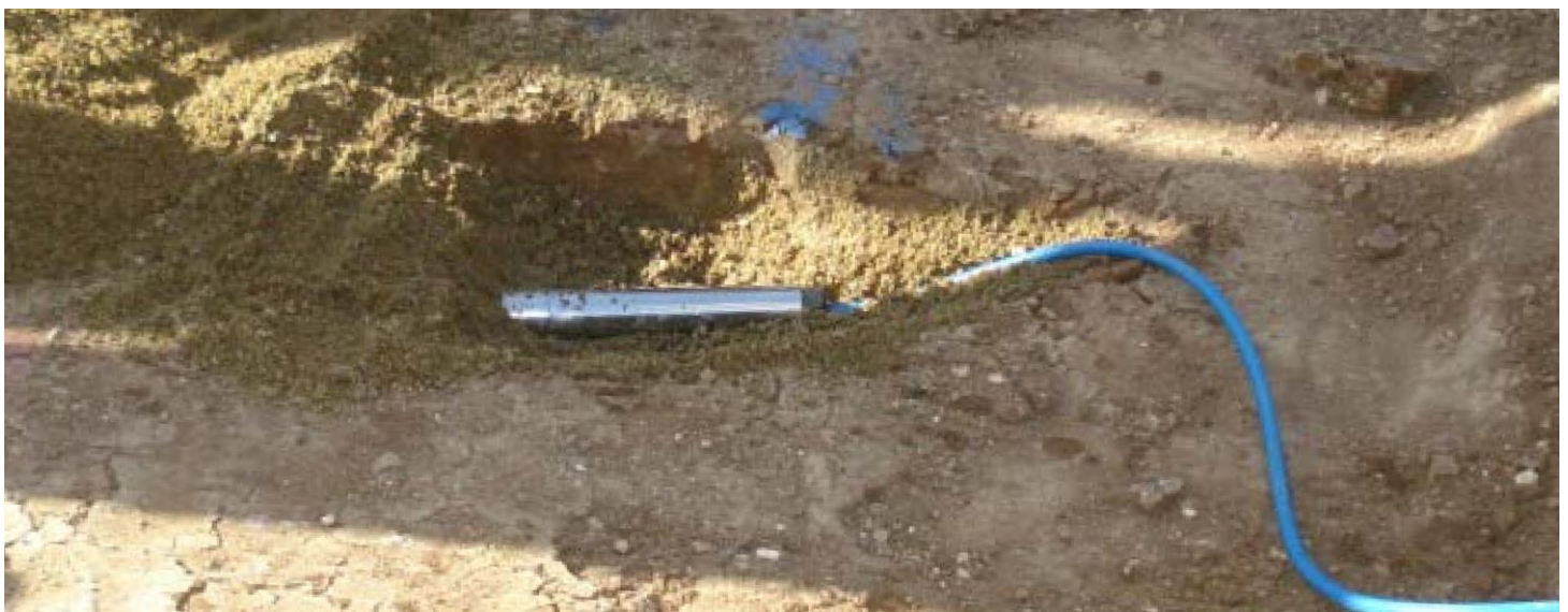
Piezometr strunowy w fundamencie zapory nasypowej
