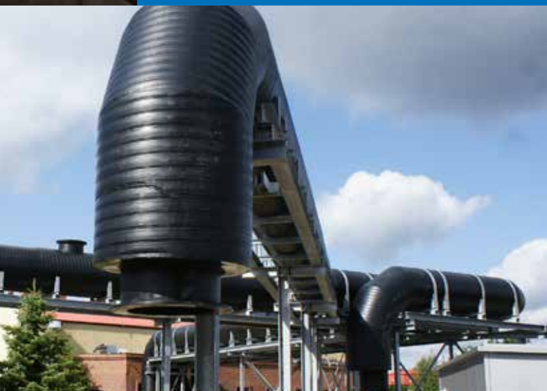
Rurociągi deodoryzacyjne, Polska
