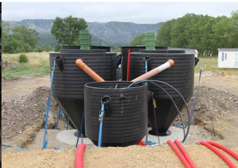
Elementy oczyszczalni ścieków, Francja
