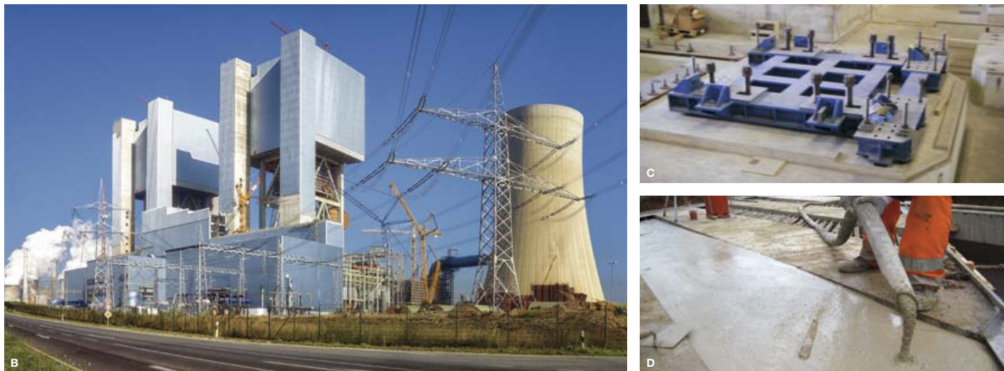
A i B. Budowa elektrowni Neurath | C. Fundament pod maszynę przed procesem podlewania | D. Zalwanie w ramach budowy mostu
