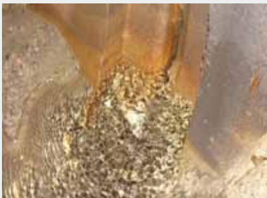
PRZECIEK WODY W KANALE BETONOWYM
