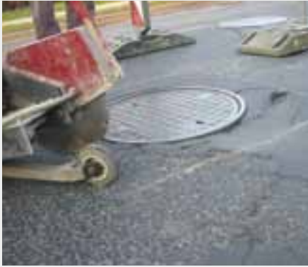
USZKODZONA STUDZIENKA W OSI DROGI
