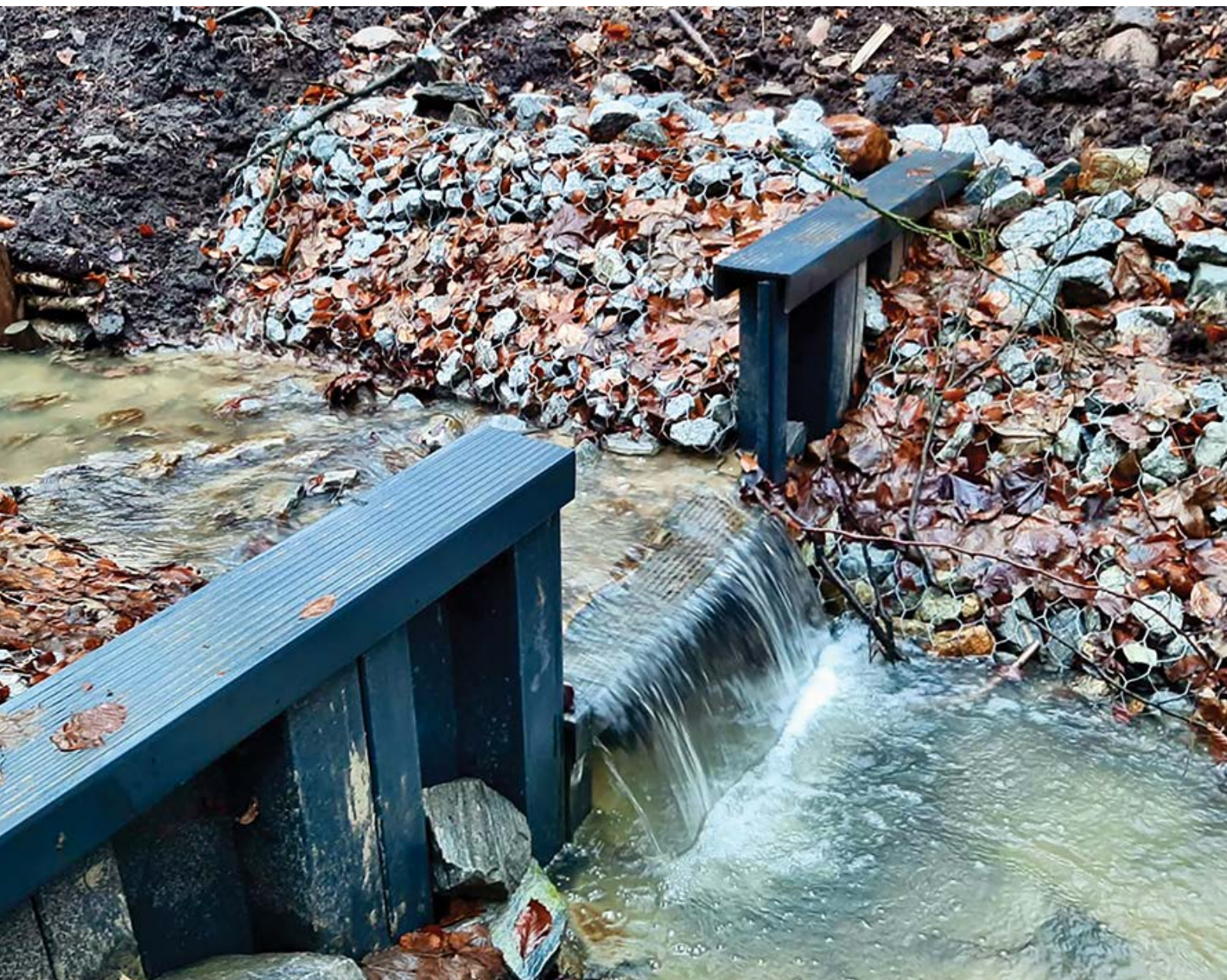
SZCZECIN, POLSKA: SYSTEM PROGÓW WODNYCH ZAINSTALOWANYCH W CELU SPOWOLNIENIA SPŁYWU WÓD POTOKU.
