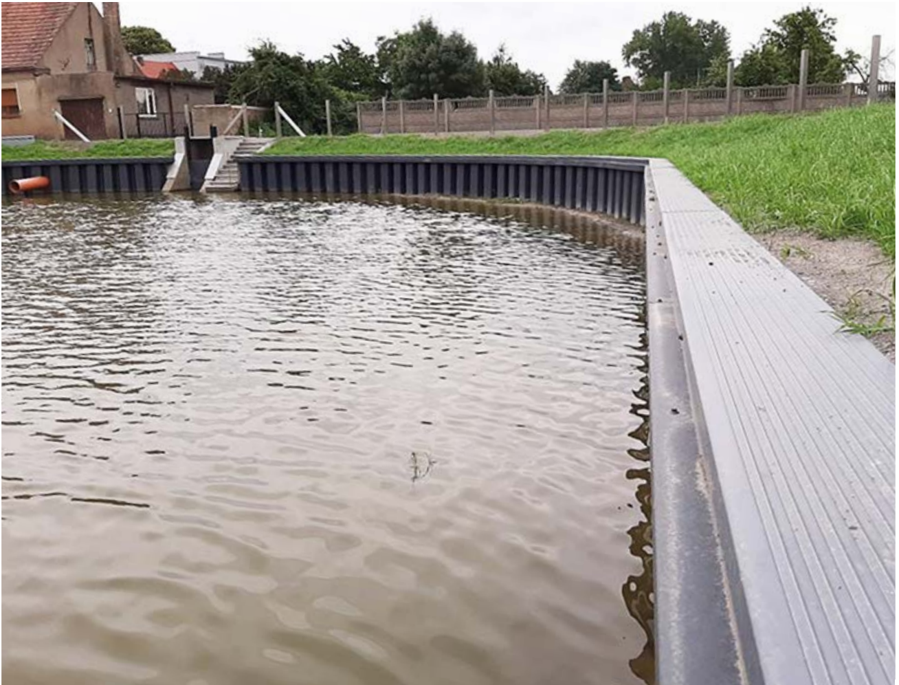
OKOLICE POZNANIA, POLSKA: REWITALIZACJA ZBIORNIKA RETENCYJNEGO - STABILIZACJA BRZEGÓW ZA POMOCĄ OPASKI Z GRODZIC WINYLOWYCH WYKOŃCZONEJ OCZEPEM I MODERNIZACJA UPUSTU WODY POPRZEZ MONTAŻ ZASTAWKI RETENCYJNEJ W ISTNIEJĄCYM JAZIE.
