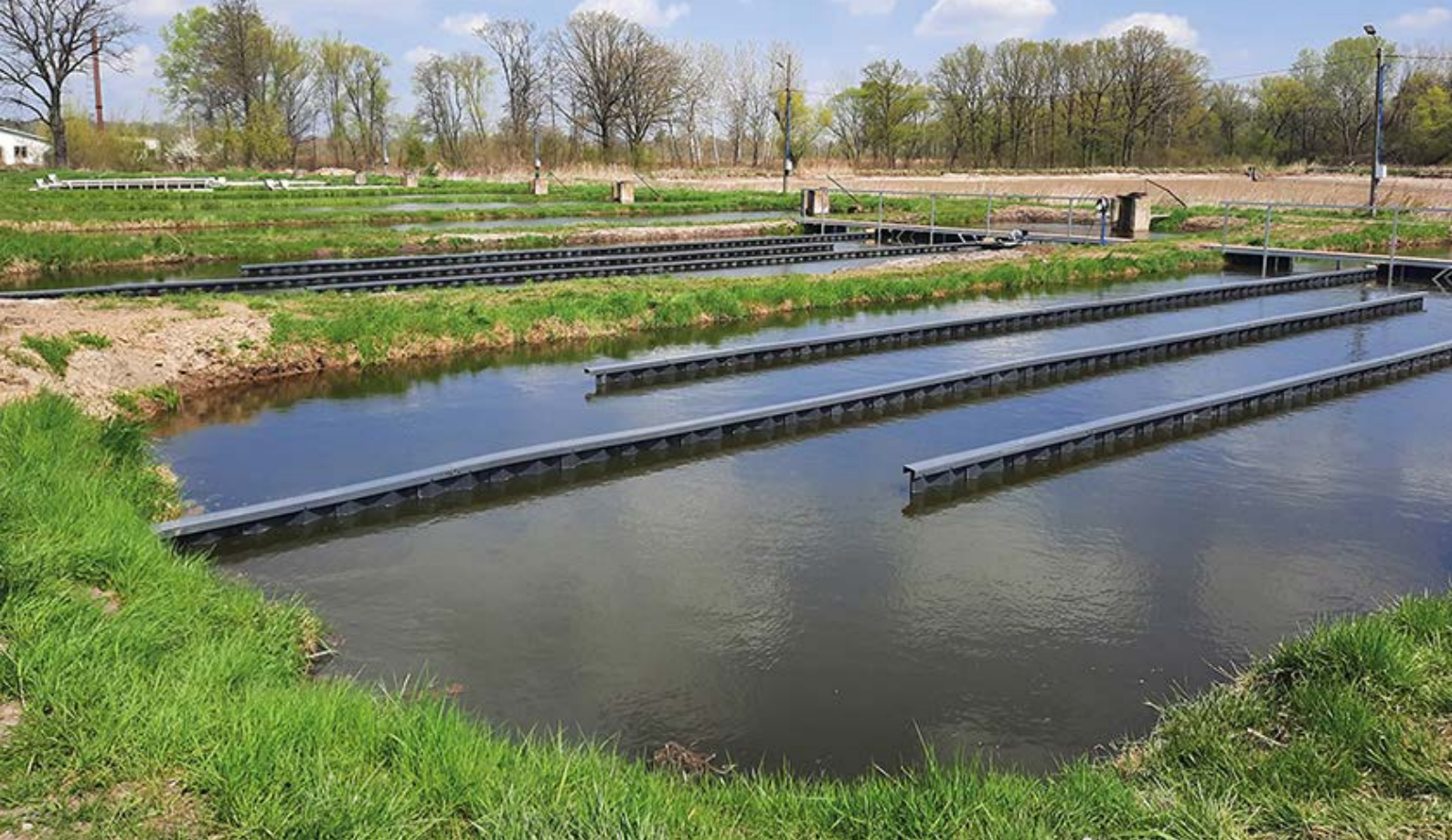
GRODZICE WINYLOWE ORAZ DESKI TARASOWE TERRADECK WYKORZYSTANO PRZY BUDOWIE INFRASTRUKTURY W OBRĘBIE KOMPLEKSU EKSPERYMENTALNYCH STAWÓW RYBACKICH W ŻABIENCU, POLSKA.
