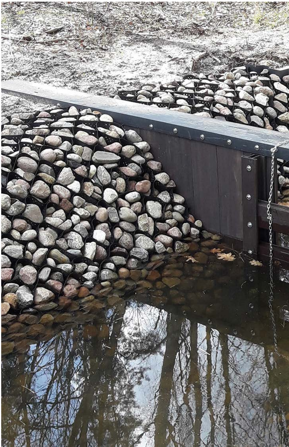
GRABÓW, POLSKA: JEDEN Z ELEMENTÓW KOMPLEKSOWEGO SYSTEMU RETENCJI KORYTOWEJ W DORZECZU PILICY.
