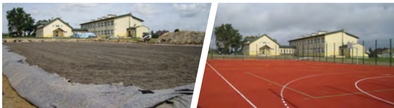
Na dużych powierzchniach boisk i bieżni keramzyt zapewnia dodatkowo ochronę przed przemarzaniem i wysadzinami oraz sprawne odwodnienie i drenaż
