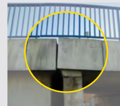
Przemieszczenie przyczółka mostu
